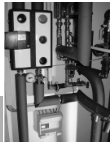
Klein, aber fein: Die Heizung wird von LOGO! gesteuert.
